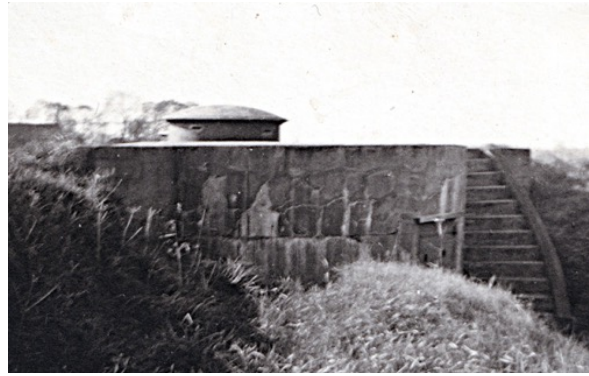
Een hefkoepelgebouw van Fort bij Aalsmeer. De koepel staat in de bovenste stand en de kanonsloop is uitgeschoven. (NL-WpDStvA C3775, 1940-1942)
