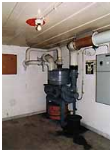
De luchtbehandelings-apparatuur van de Landmacht. (René Roede)
