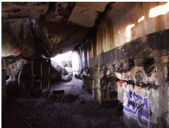
Het interieur van voorheen twee verdiepingen in het opgeblazen hoofdgebouw van Redoute Schilde. (René Ros, 2009)
