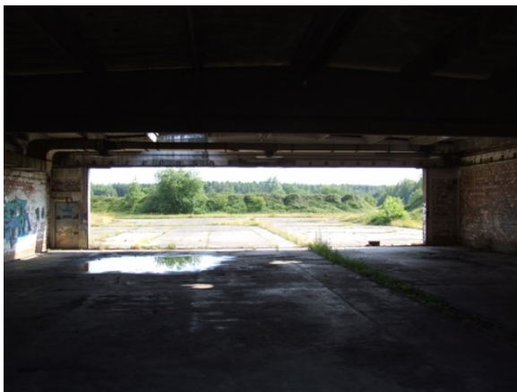
Blik vanuit de lekkende hangar van sectie B. (René Ros)
