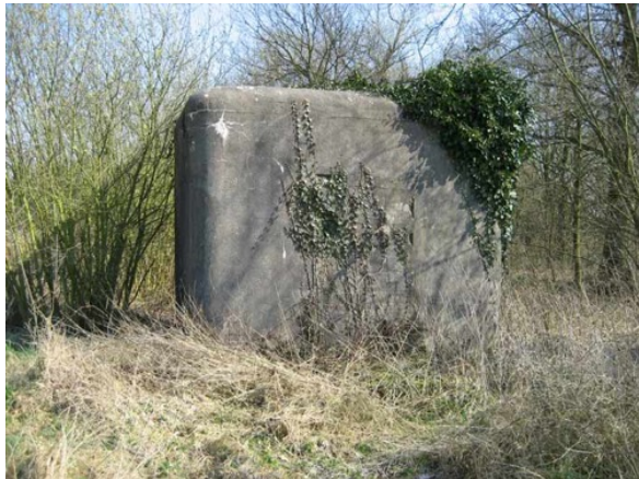
De toegangszijde van de connectiebunker VA31 bij Rijmenam. (Ron Erhardt, 2009)
