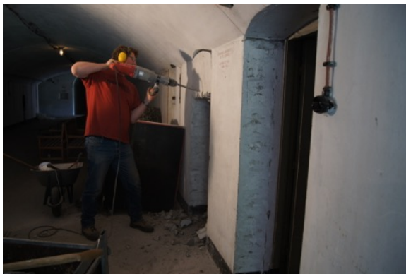
René Ros breekt met een sloophamer een van de dichtgemetselde deuropeningen in Fort bij Uithoorn uit. (Hans Baas, 2013)
